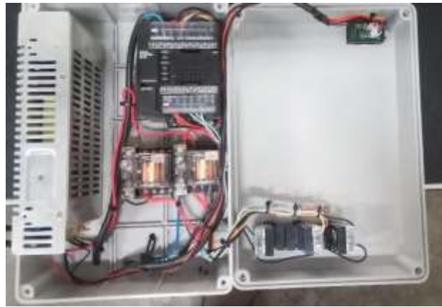
Gambar 7. Panel Kontrol Bagian Dalam
