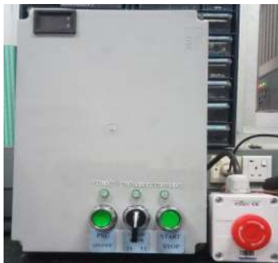
Gambar 6. Panel Kontrol Bagian Depan
